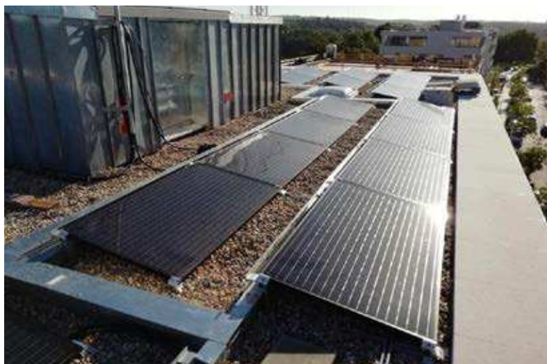
40 panneaux hybrides fournissent de l'électricité et de l'énergie thermo-solaire.
